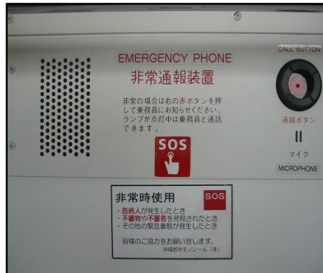
車椅子スペース部 非常通報装置
